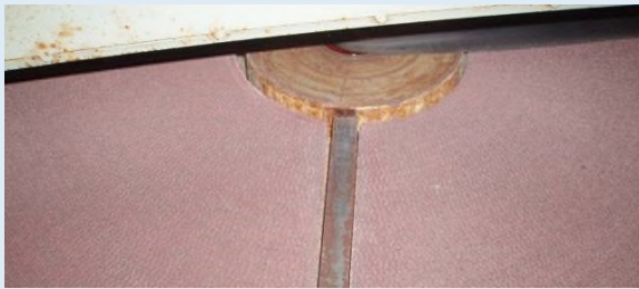
剥離して隙間が見られる
