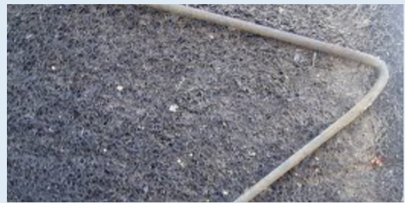
汚れたフィルター
